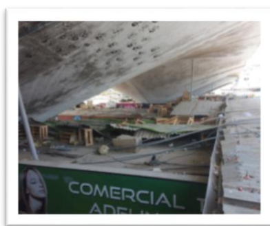
Figura N°163 TECHOS CON DESPERDICIOS FUENTE: PROPIA
