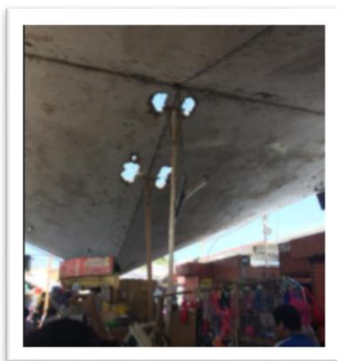
Figura N°161 ESTRUCTURA HIPERBÓLICA EN MAL ESTADO FUENTE: PROPIA – INTERIOR DEL MERCADO
