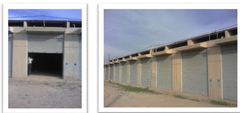
Figura N°179 PABELLONES EN REGULAR ESTADO FUENTE: PROPIA
