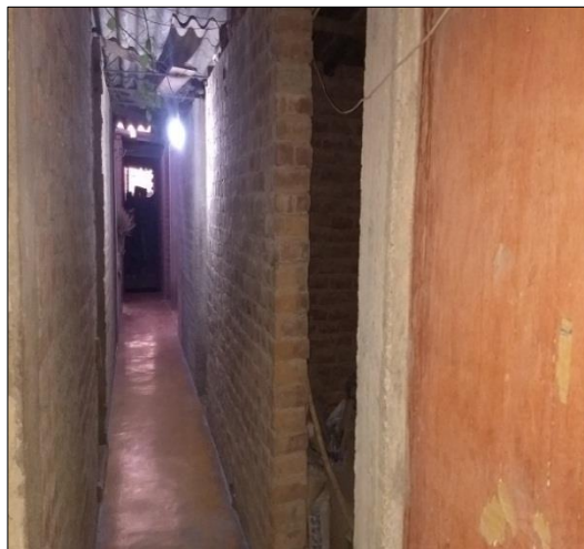
Presencia de tabiquería sin arriostrar.
