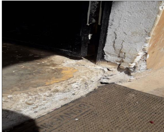
Desmoramiento de concreto en columnas.
