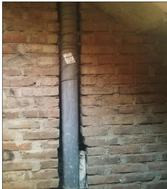
Tubería de desagüe expuesta.
