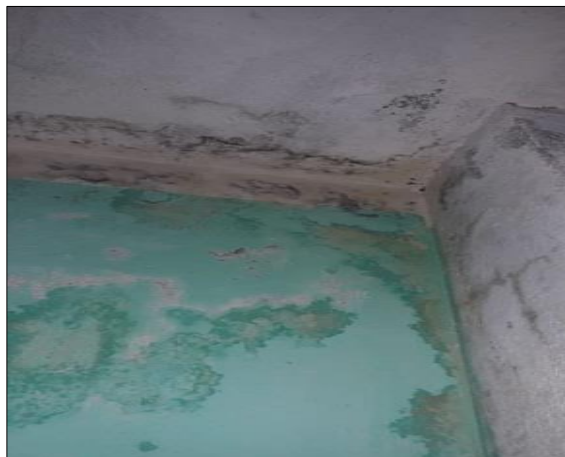
Eflorescencia en muro por humedad.
