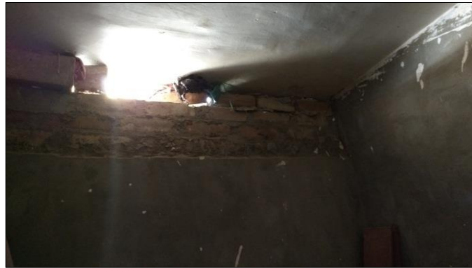
Muro sin arriostre y con juntas mayor a 1.5cm.
