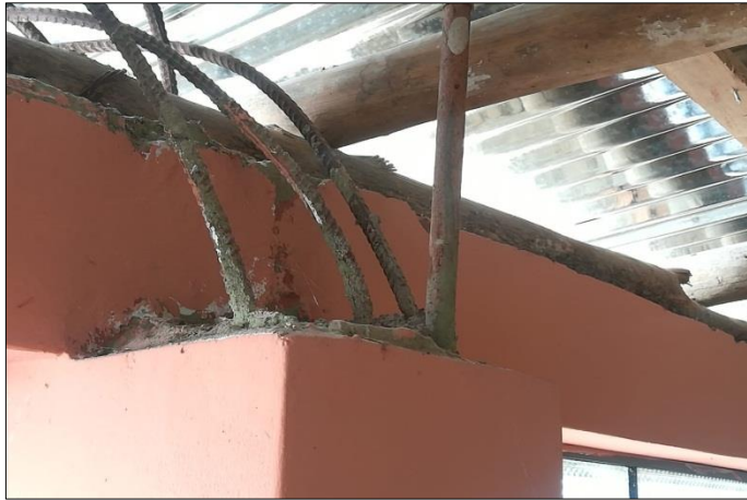
Corrosión del acero de columna por exposición.
