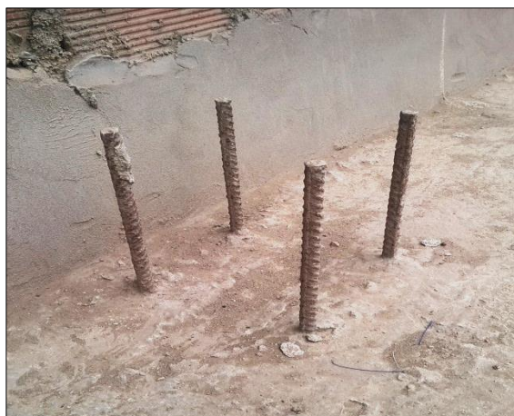
Acero de columna expuesto a la corrosión.
