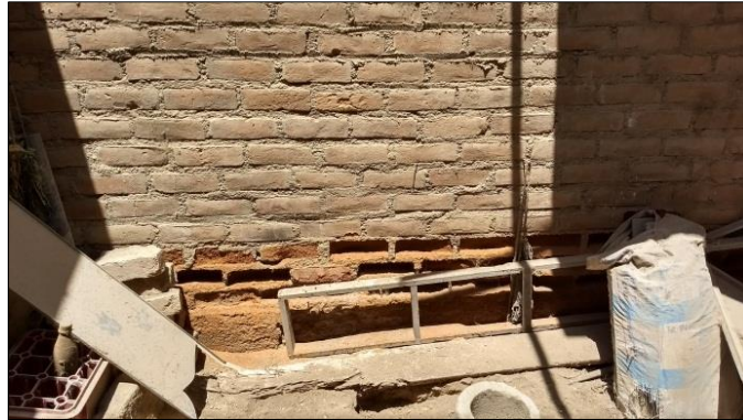
Humedad y salitre causan el deterioro del muro de albañilería.
