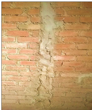
Mala calidad de mano de obra. Juntas mayores de 1.5cm.
