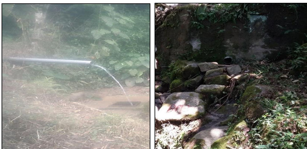
Figura 13: Captaciones totalmente colapsadas
