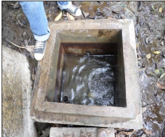
Figura 15: Estructura deteriorada Fuente: Elaboración propia.
