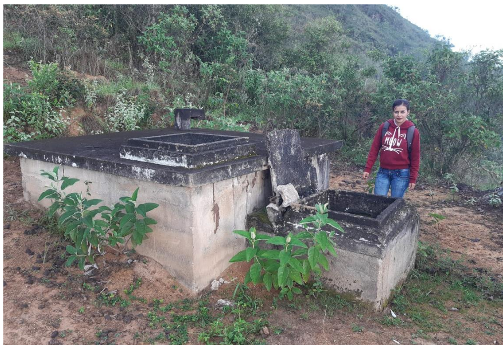
Figura 19: Reservorio existente deteriorado.
