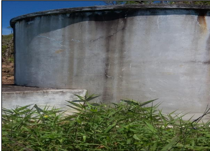
Figura 14: Malas condiciones del reservorio con presencia de fisuras. Fuente: Elaboración propia.
