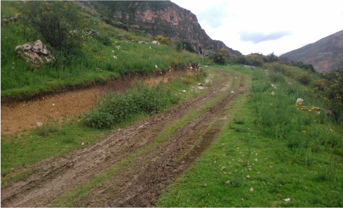
Figura 3. Gravedad 3: Huellas/hundimientos \geq 10 cm
