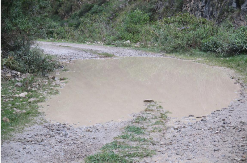
Figura 7. Gravedad 1: Pueden repararse por mantenimiento rutinario
