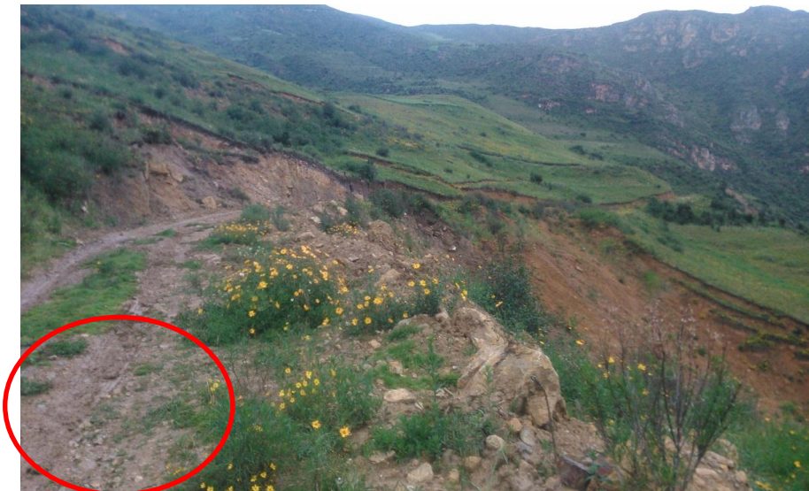
Figura 2. Gravedad 2: Huellas/hundimientos entre 5 cm y 10 cm
