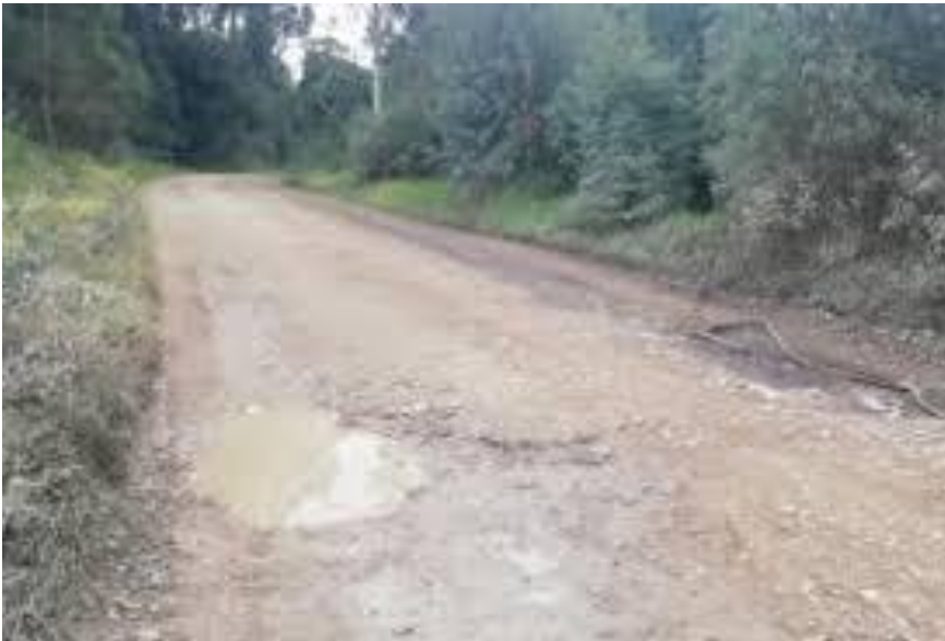
Figura 5. Gravedad 2: Profundidad entre 5 cm y 10 cm
