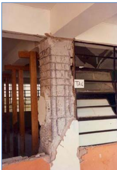
Figura 3: Falla en columna corta en Edificio 780 Actual
