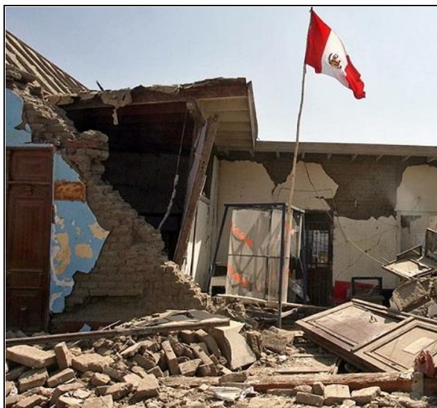
Figura N° 1: Vivienda de adobe ante el sismo-pisco 2007. Fuente: Americatv.com.pe
