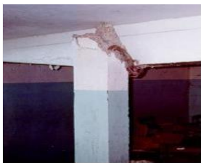
Figura N° 15: Falla por mala conexión de columna y viga.
