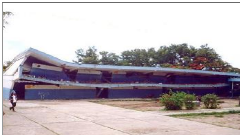
Figura N° 14: Estructura escolar colapsada ante la resistencia a corte inadecuada
