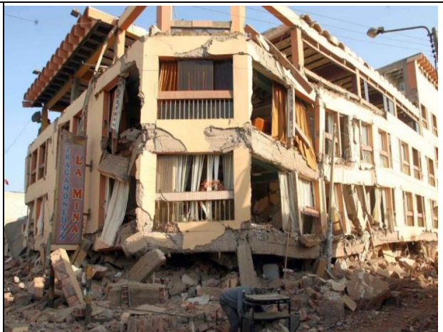
Figura N° 4: Edificación ante el mal Predimensionamiento de elementos estructurales. Fuente: elcomercio.pe
