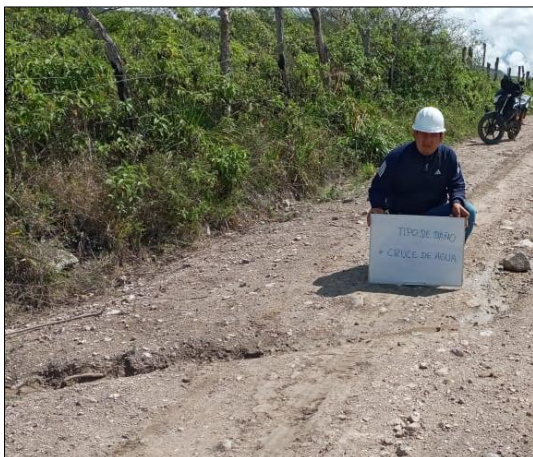
Figura 11. deterioro cruce de agua.
