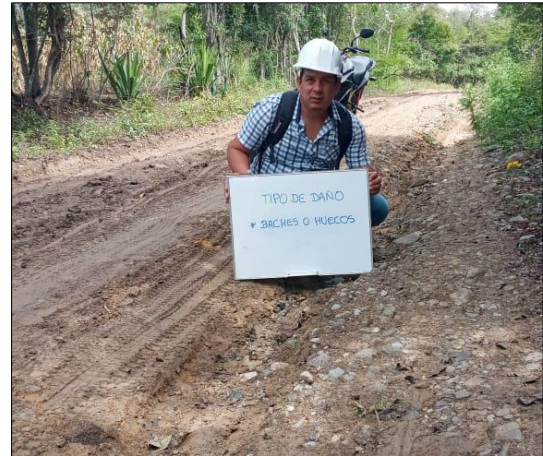
Figura 10. Deterioro de baches o huecos.
