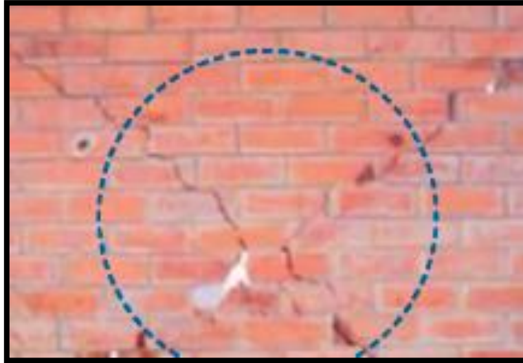
Ilustración 26:Grietas centrales en el muro
