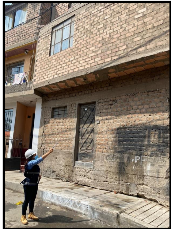
Ilustración 19: Mal uso del ladrillo pandereta
