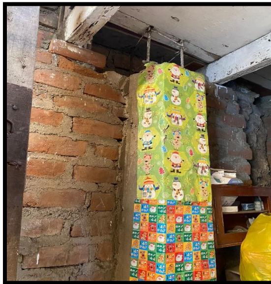
Ilustración 20: Muros sin viga solera
