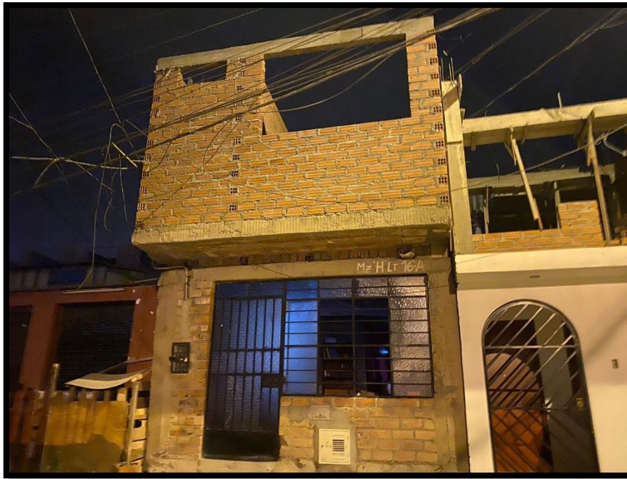
Ilustración 23: Viviendas sin junta sísmica y desnivel de losa de techo
