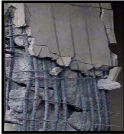
Ilustración 16:Falla por compresión fuelle: (Fallos más comunes en columnas de concreto armado, 2021)
