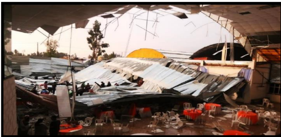
Ilustración 4:Caída del Techo en Salón de Recepciones dejó 6 muertos, Huancán
