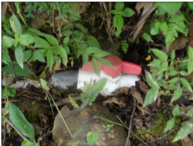
FOTO N° 04 LLAVES EN MAL ESTADO GENERAN FILTRACION
