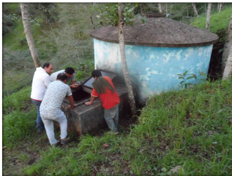
FOTO N° 02 RESERVIRIO EN MAL ESTADO HA REHABILITARSE
