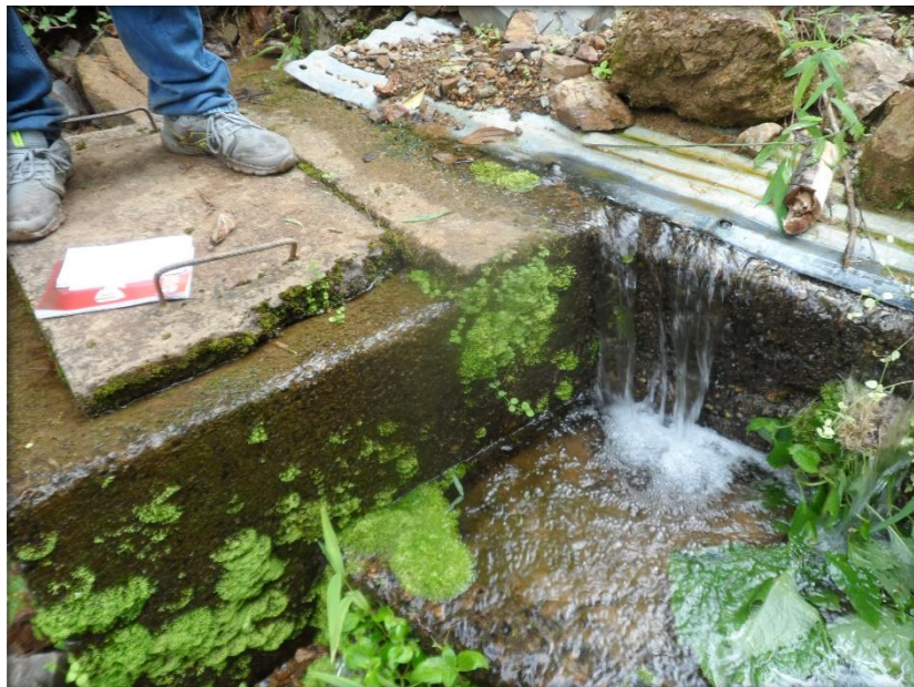
FOTO N° 01 CAPTACIÓN EN MAL ESTADO (QUEBRADA SAN ANTONIO)
