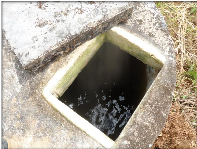
FOTO N° 03 AGUAS NO APTAS PARA CONSUMO
