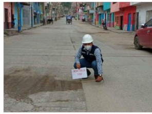
PAÑO 07 - COD. 25 - FALLA DE ESCALA - SEVERIDAD MEDIA
