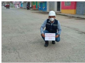
PAÑO 20 - COD. 31 - PULIMIENTO DE AGREGADOS SEVERIDAD ALTA
