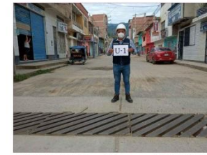
UNIDAD DE MUESTRA 01 - PAÑO 01 - 02 - REJILLA METALICA
