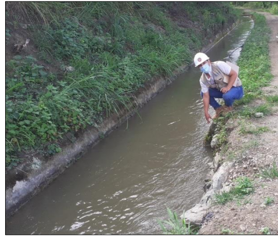
Figura 6. Identificación de patologías (desprendimiento)
