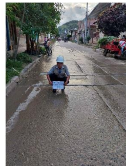
PAÑO 209 - SUPERFICIE DE PULIMENTOS SEVERIDAD MEDIO
