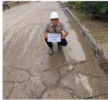
PAÑO 98 - DESCONCHAMIENTO, MAPA DE GRIETAS SEVERIDAD MEDIO
