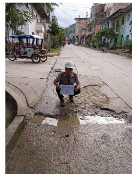
UM-09 - PAÑO 143 - DESCONCHAMIENTO Y ESCALA DE SEVERIDAD ALTO
