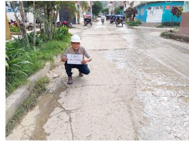
UM-01 - PAÑO 07 - LOSA DIVIDIDA DE SEVERIDAD ALTA
