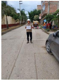
PAÑO 76 - PARCHE GRANDE SEVERIDAD LEVE
