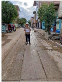
PAÑO 32 - PARCHE GRANDE SEVERIDAD LEVE
