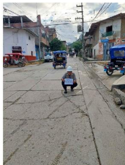
PAÑO 184 - LOSA DIVIDIDA Y G. LINEALES SEVERIDAD MEDIO
