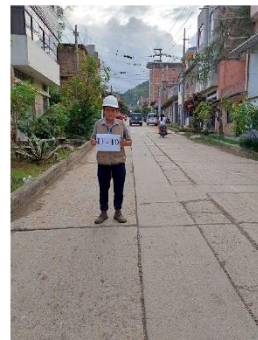
UM-10 - PAÑOS DEL 145 AL 160 PROGRASIVA 00+345.71 km
