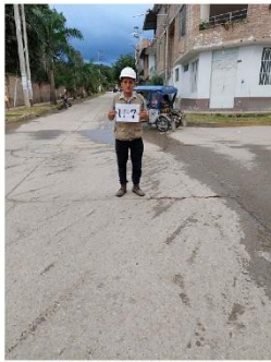
UM-07 - PAÑOS DEL 97 AL 112 PROGRASIVA 00+228.77 km
