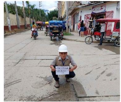
PAÑO 62 - GRIETAS LINEALES SEVERIDAD MEDIO
