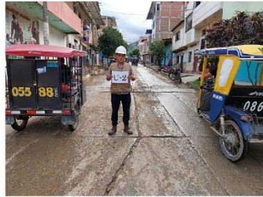
UM-02 - PAÑOS DEL 17 AL 32 PROGRASIVA 00+39.32 km
