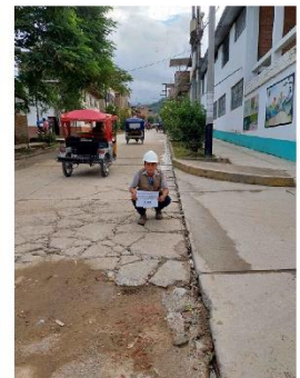
UM-09 - PAÑO 136 - DESCONCHAMIENTO MAPA DE GRIETAS DE SEVERIDAD ALTO
