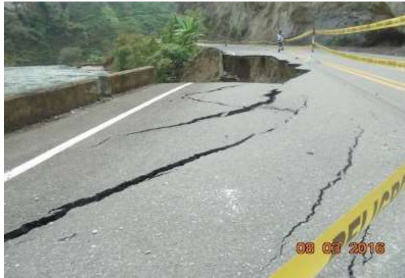
Figura 11. Foto del colapso de la carretera en el año 2016.
