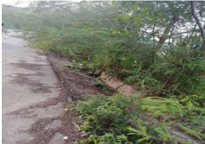
Figura 9. Foto de presencia de vegetación en carretera.
