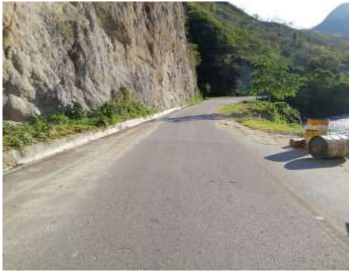
Figura 12. Foto del estado actual de la carretera, tras colapso.
