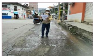
PAÑO 215 - FALLA DESCONCHAMIENTO, MAPA DE GRIETAS, CRAQUELADO DE SEVERIDAD ALTA
