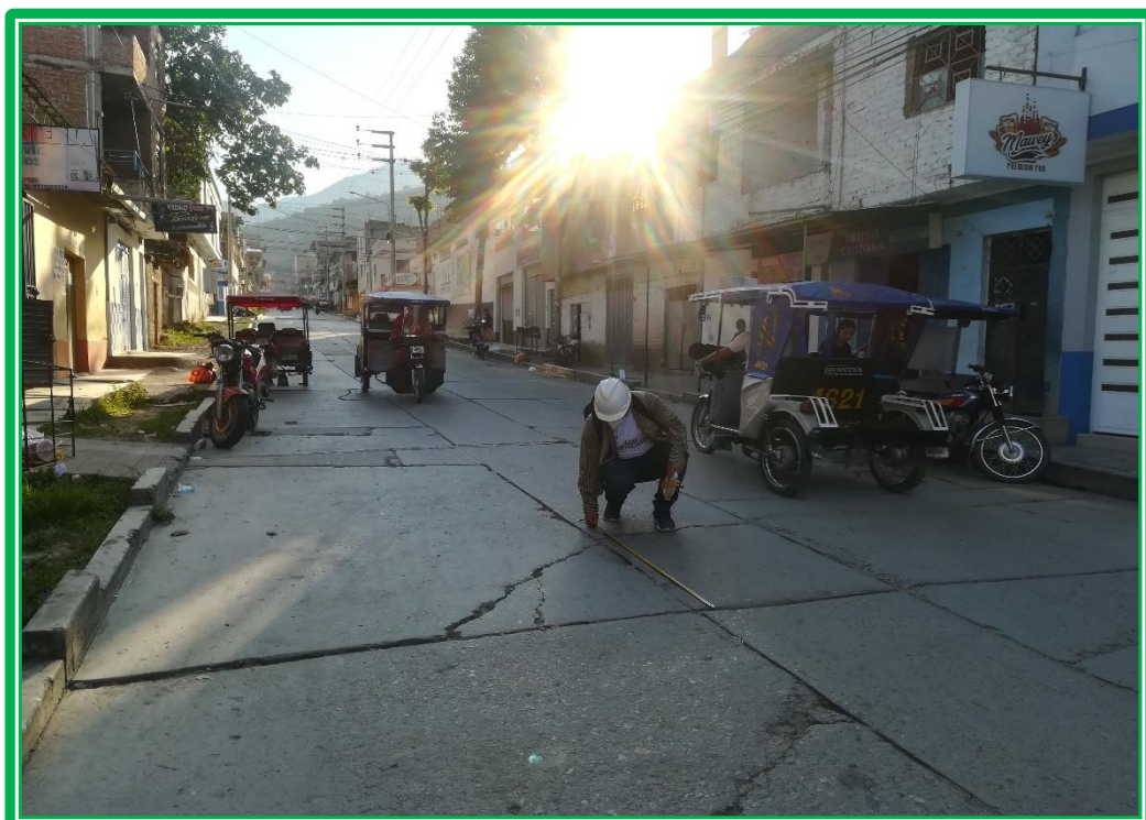
Foto 28. Paño 142, en la U-08, en la Cuadra N° 12, con fallas 01 Grieta de Esquina de severidad medio; 02 Parche Grande (29) de severidad Alto.
