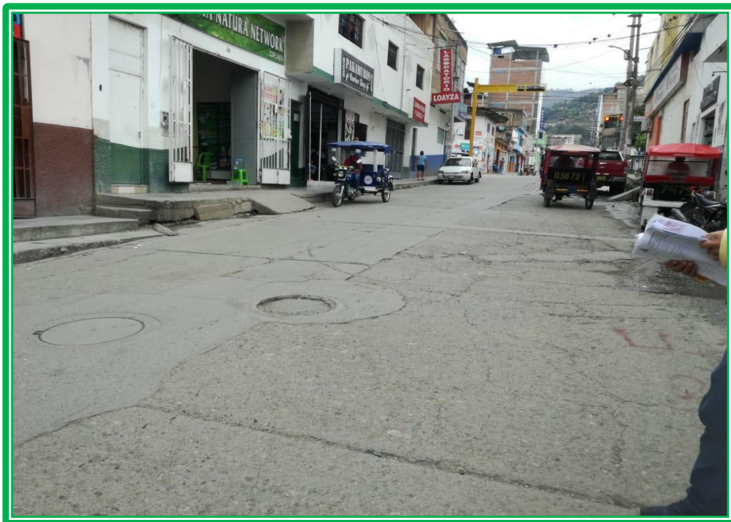
Foto 36. Paño 201, en la U-11, en Progresiva 0+532.20 Km, en la Cuadra N° 14 de la calle Iquitos, presenta fallas Grietas Lineales (28) de severidad Media y Pulimiento de Agregados (31) de severidad alto
