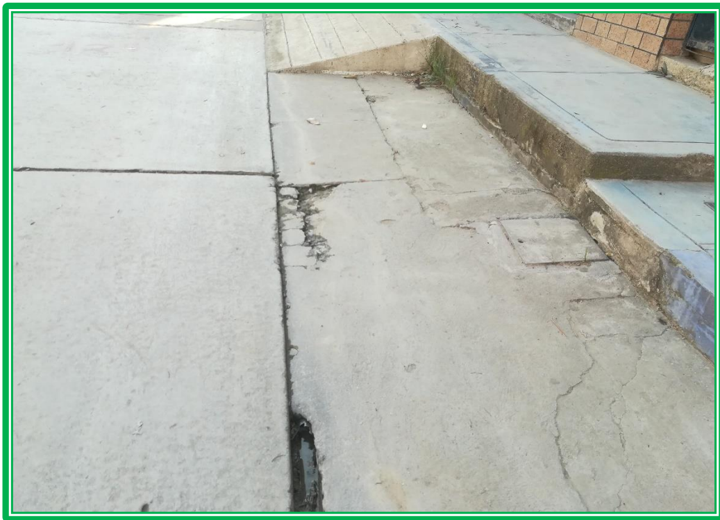
Foto 22. Paño 113, en la U-07, en la Cuadra N° 11, con Berma en Mal estado.
