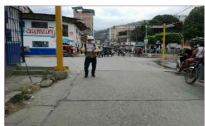
PAÑO 218 - FINAL DE LA CALLE EN ESTUDIO FALLA DE NIVEL UERMA SEVERIDAD ALTA
