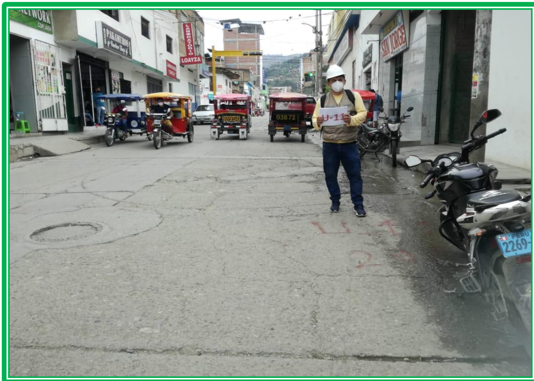
Foto 35. Paño 201, en la U-11, en Progresiva 0+532.20 Km, en la Cuadra N° 14 de la calle Iquitos, Pavimento en Mal estado.
