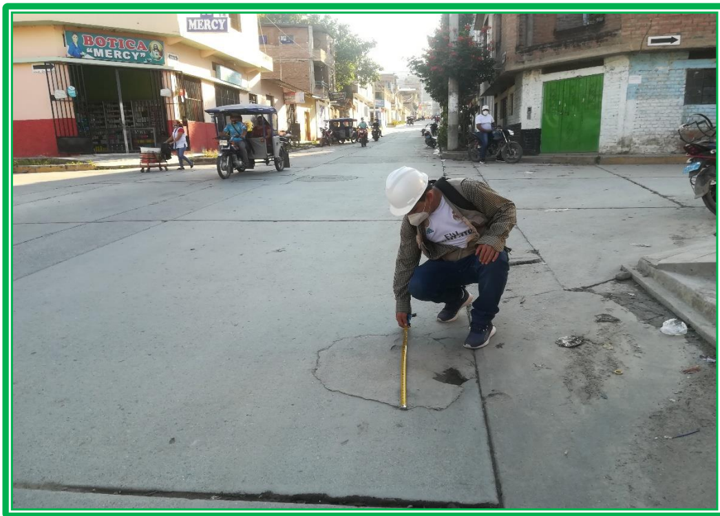
Foto 23. Paño 115, en la U-07, en la Cuadra N° 11, con fallas 01 Parche Grande (29) de severidad Medio.
