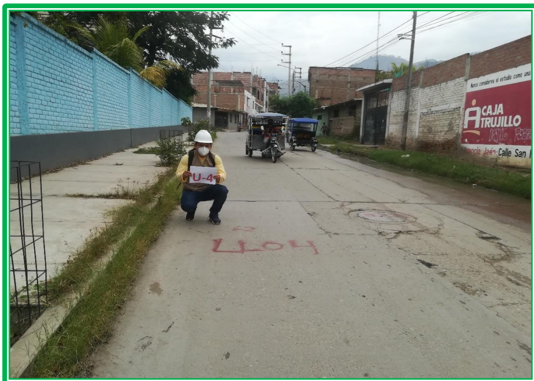
Foto 10. Paño 62, de 3.50 x 5.00 m en la U-04, en la Progresiva 0+147.5 Km, en la Cuadra N° 09, con fallas de 01 Parche Grande severidad Medio.
