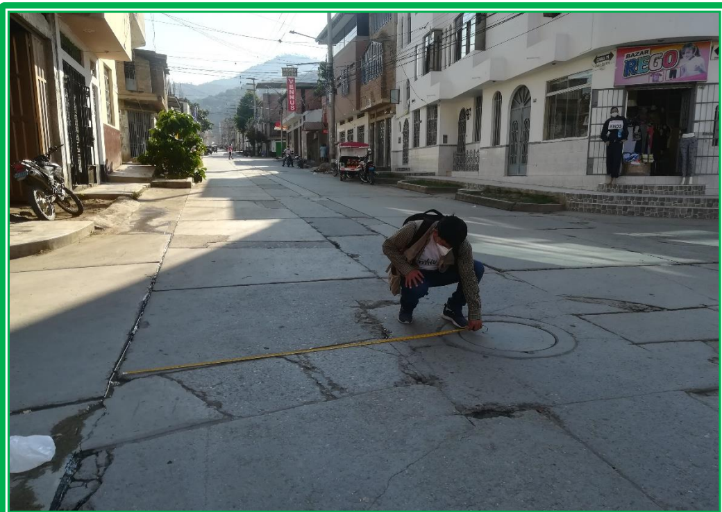
Foto 20. Paño 106, en la U-06, en la Intersección de la Calle Iquitos y Garcilazo de la Vega, con medición y fallas 02 Parche Grande (29) de severidad Medio y uno Alto.
