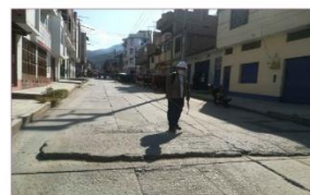
PAÑO 86 - ROMPEMUELLE EN MAL ESTADO Y PARCHES GRANDES EN SEVERIDAD ALTA
