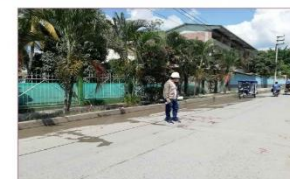
PAÑO 7. B IDENTIFICACIÓN Y SEALIZACION DE FALLAS A UN COSTADO VIVERO MUNIC. PROV. JAÉN
