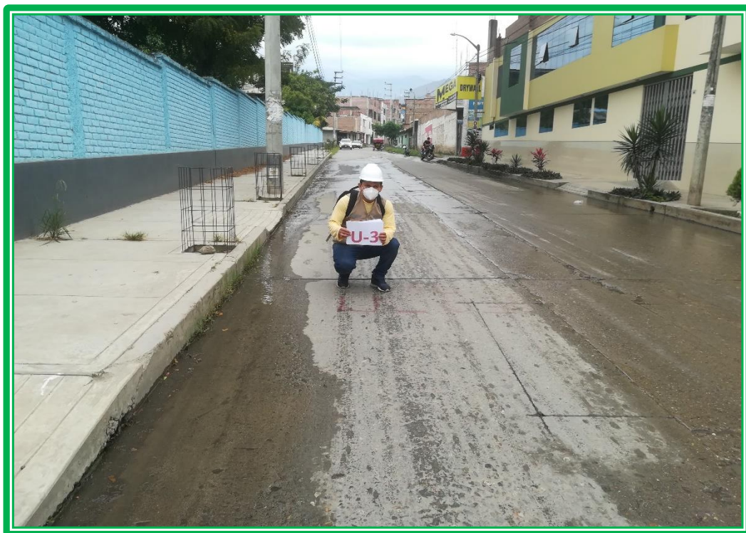
Foto 08. Paño 42, de 3.50 x 5.00 m en la U-02, en la Progresiva 0+097.5 Km, en la Cuadra N° 09, con fallas de 01 Parche grande severidad Alto.
