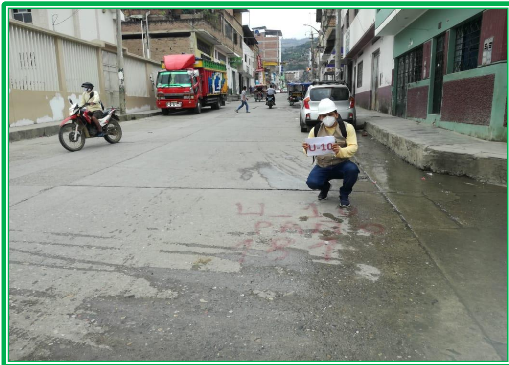
Foto 33. Paño 181, en la U-10, en Progresiva 0+482.45 Km, en la Intersección de las Calles Iquitos y Pasaje Chillón.
