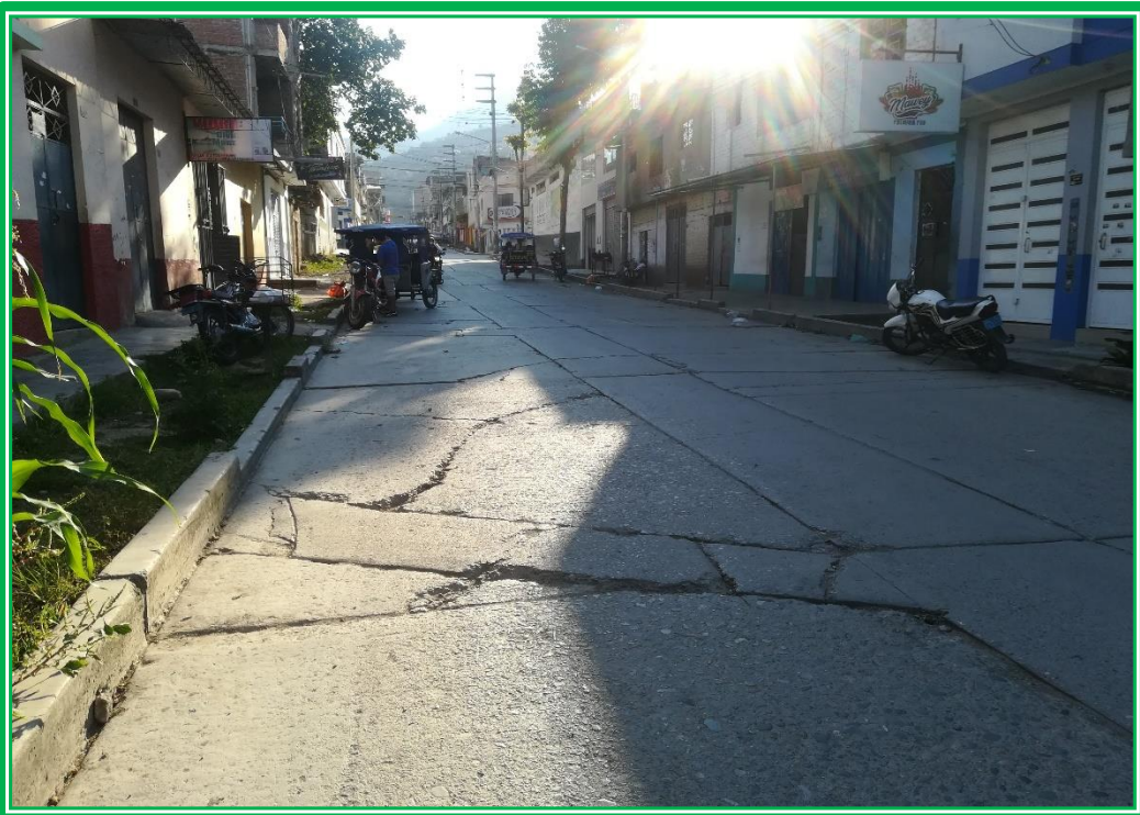
Foto 26. Paño 140, en la U-07, Cuadra N°12, con Falla de 01 Losa dividida con severidad Alto; 02 Parche grandes (29) con severidad medio y alto.
