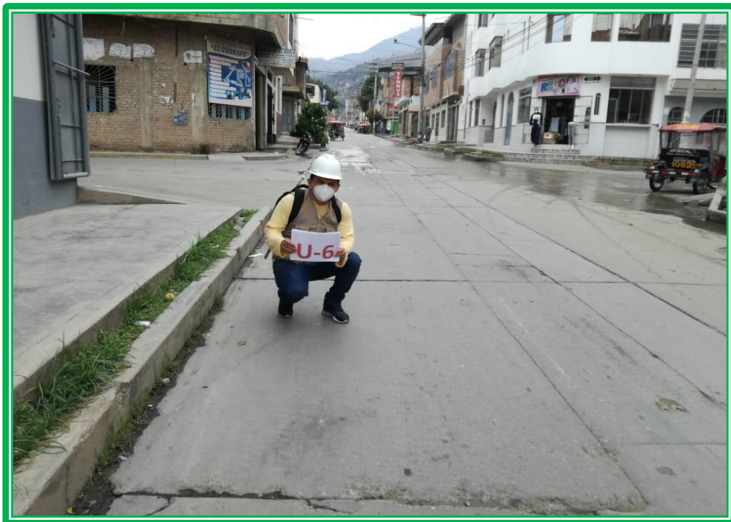
Foto 19. Paño 102, en la U-06, en Progresiva 0+248.25 Km, en la Cuadra N° 10, con fallas 02 Parche Grande (29) de severidad Alto.
