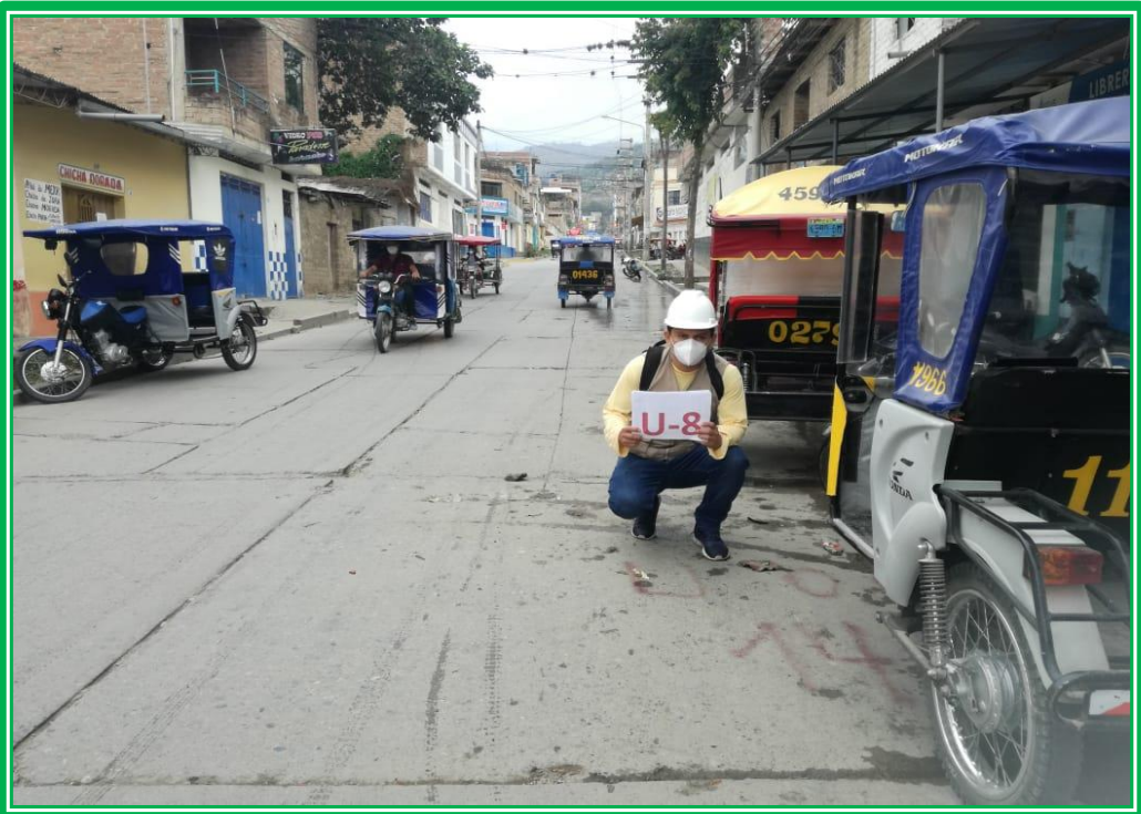
Foto 27. Paño 141, en la U-08, en Progresiva 0+348.25 Km, en la Cuadra N° 12, con fallas 02 Grietas Lineales (28) de severidad Medio y alto; 01 Parche Grande (29) de severidad Alto.
