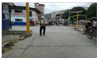
PAÑO 218 - FINAL DE LA CALLE EN ESTUDIO FALLA DESNIVEL DE BERM SEVERIDAD ALTA
