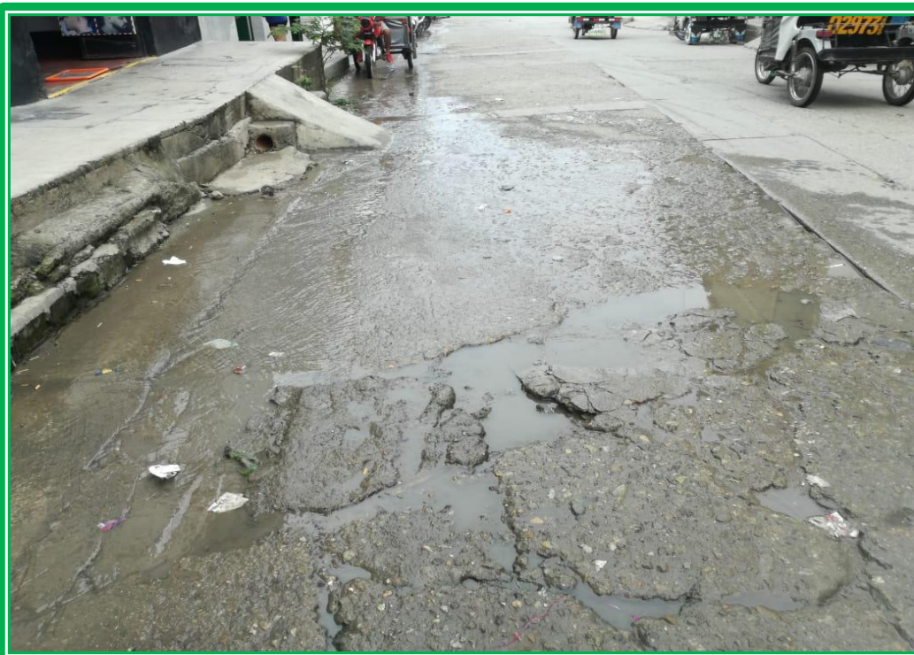
Foto 37. Paño 213, en la U-11, en la Cuadra N° 14 de la calle Iquitos, Paño en Mal estado.
