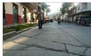
PAÑO 140 - LOSA DIVIDIDA DE SEVERIDAD ALTA
