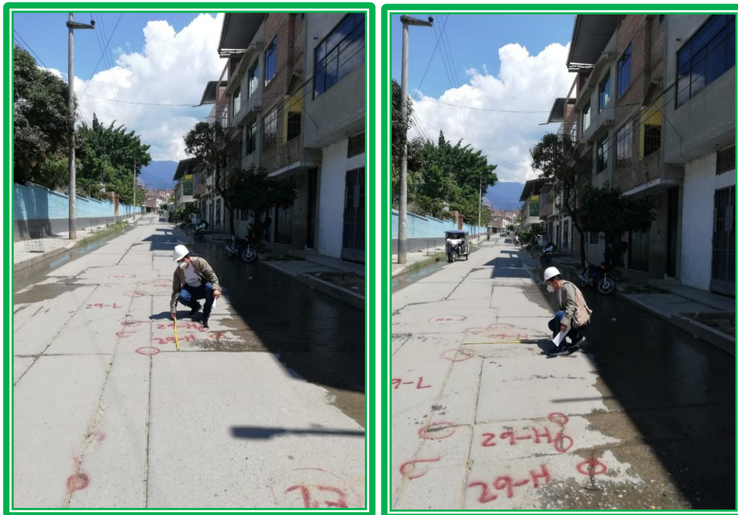
Foto 04. Izq. Paño 19, de 3.50 x 5.00 m en la Unidad de Muestra U-01, con fallas de 02 Parche Grande (29) de severidad Alto; Der. Medición del Buzón N° 01 Tapa en mal estado.
