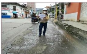
PAÑO 215 - FALLA DESCONCHAMIENTO, MAPA DE GRIETAS, - CRAQUELADO DE SEVERIDAD ALTA
