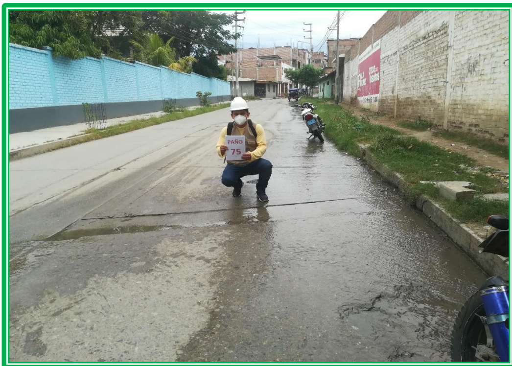
Foto 12. Paño 75, en la U-04, con fallas de 02 Fallas de Parche Grande (29) de severidad Alto y 01 Pulimiento de superficie (31) de severidad Alto.
