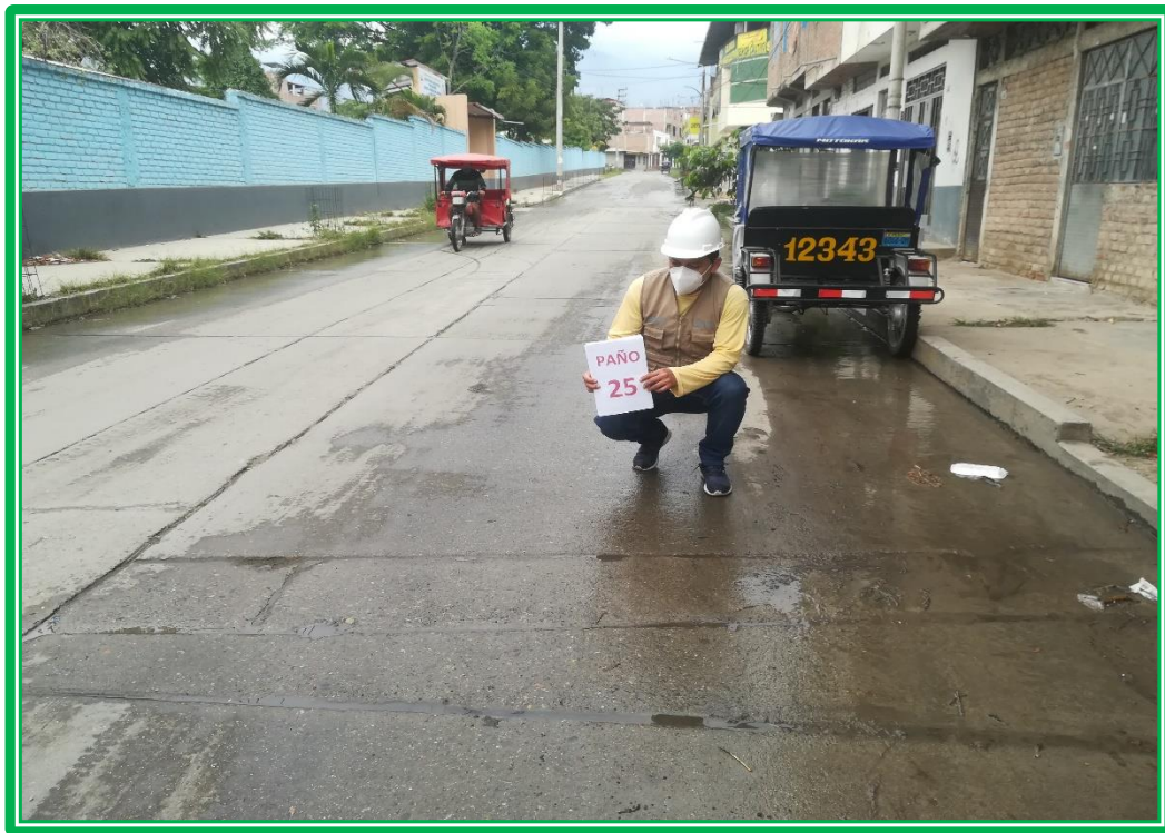
Foto 07. Paño 25, de 3.50 x 5.00 m en la U-02 , con fallas de 01 Parche Grande severidad Alto.
