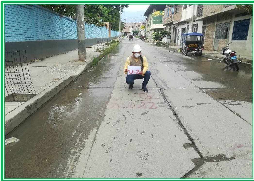
Foto 05. Paño 22, de 3.50 x 5.00 m en la U-02 , en la Progresiva 0+047.5 Km, en la cuadra N° 08, con fallas de 02 Parche Grande (29) de severidad Alto.
