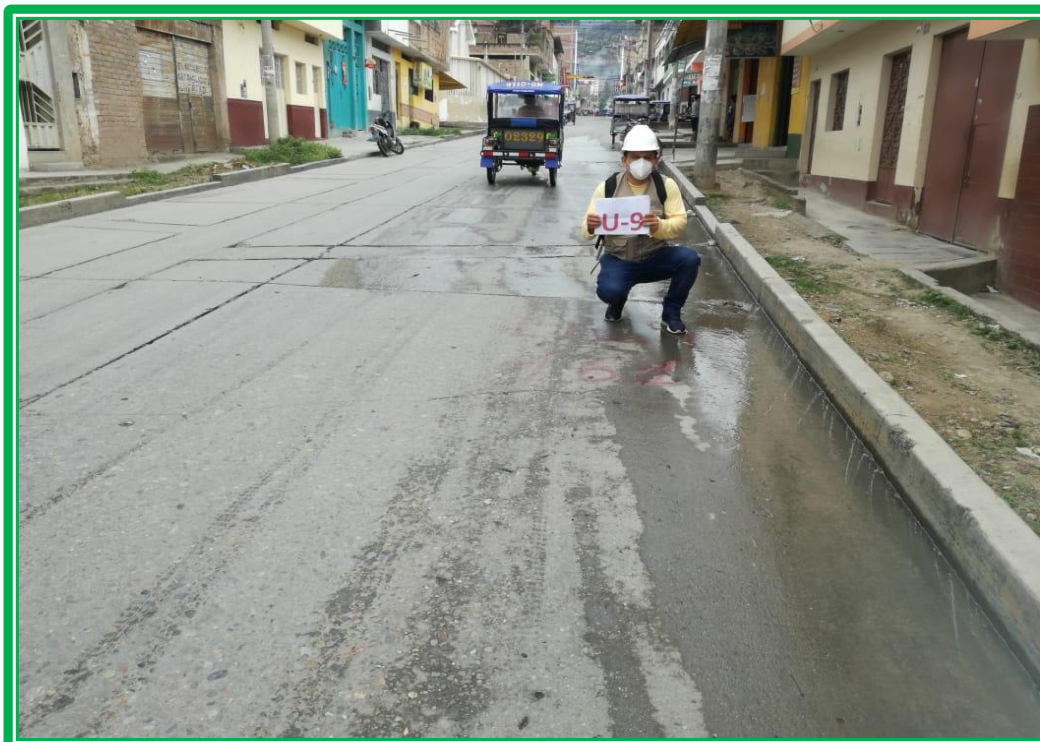
Foto 32. Paño 161, en la U-09, en Progresiva 0+422.45 Km, en la Cuadra N° 13, con fallas 01 Grietas Lineales (28) de severidad alto.
