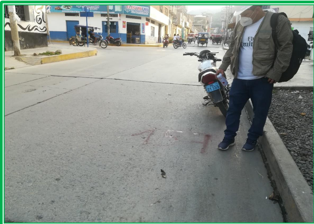
Foto 30. Paño 157, en la U-08, en la Cuadra N° 12, no presenta fallas este paño, los 03 paños próximos no se consideraran por pavimento nuevo, Jardines en mal estado.
