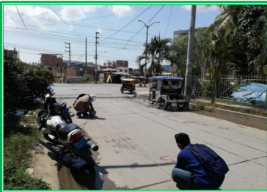
Foto 02. Medición del Paño 5, de 3.50 x 5.00 m en la Unidad de Muestra U-01 , con fallas de Pulimiento de superficie (31) de severidad Medio .
