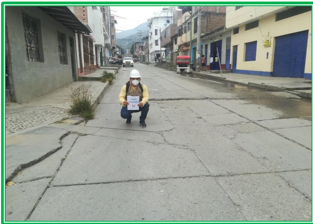
Foto 14. Paño 82, en la U-05, en Progresiva 0+198.0 Km, en la Cuadra N° 10, con fallas de 01 Escala (23) de severidad Alto ; 01 Parche Grande severidad Alto y Desconchamiento, Mapa De Grietas, Craquelado (36) de severidad Medio.
