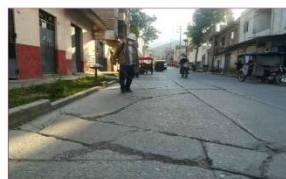
DAÑO 140 - LOSA DIVIDIDA DE SEVERIDAD ALTA
