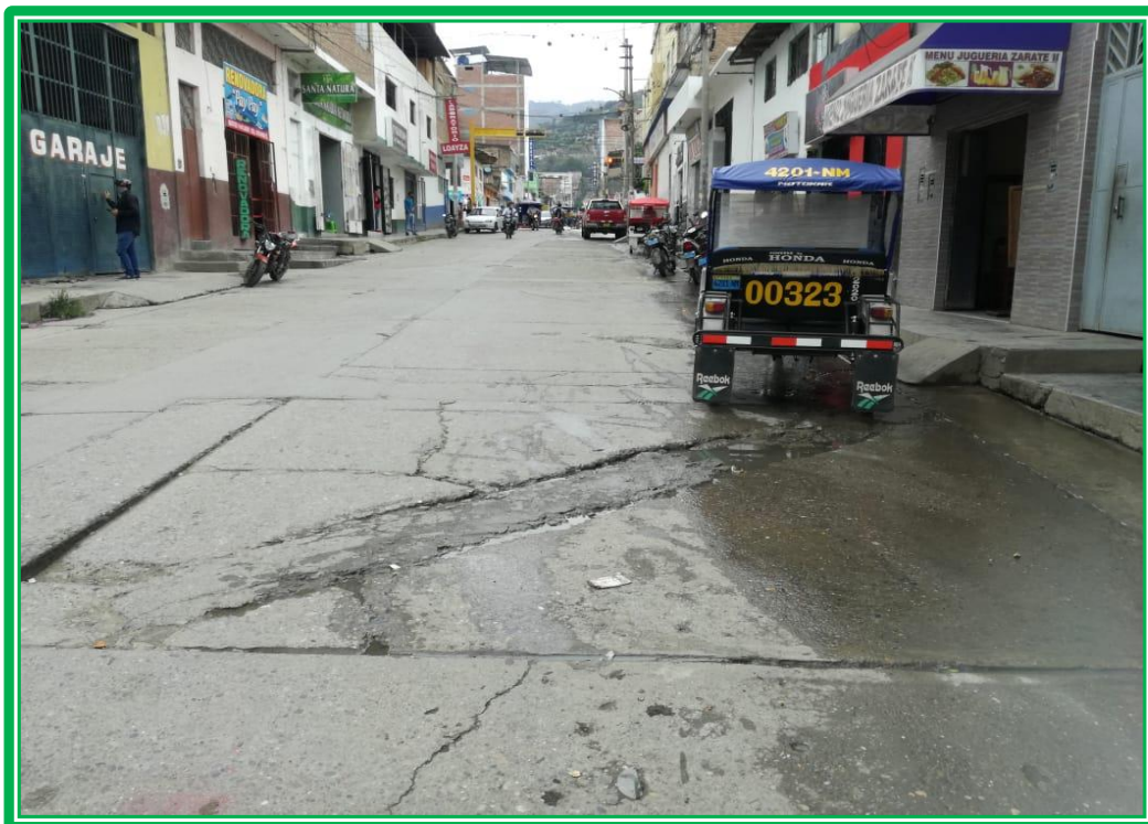
Foto 34. Paño 193, en la U-10, en la cuadra N° 014, presenta Fallas de 01 losa dividida severidad Alto, 01 parche grande severidad alto; 01 Pulimiento de Agregados severidad alto.
