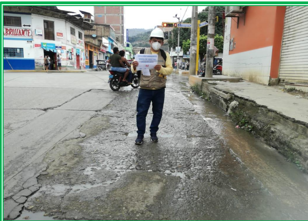
Foto 38. Paño 215, en la U-11, en la Cuadra N° 14, Paño en Mal estado, veredas en mal estado, Parte más crítica de la Calle Iquitos.
