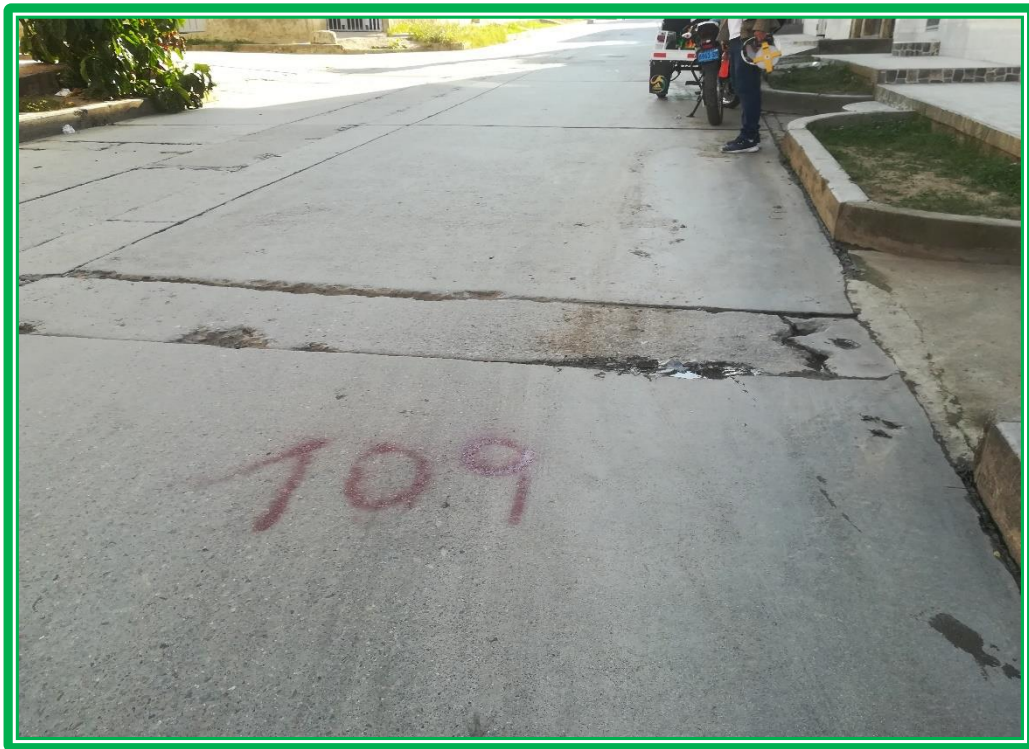
Foto 21. Paño 109, en la U-06, en la Cuadra N° 11, con fallas 01 Parche Grande (29) de severidad Medio.
