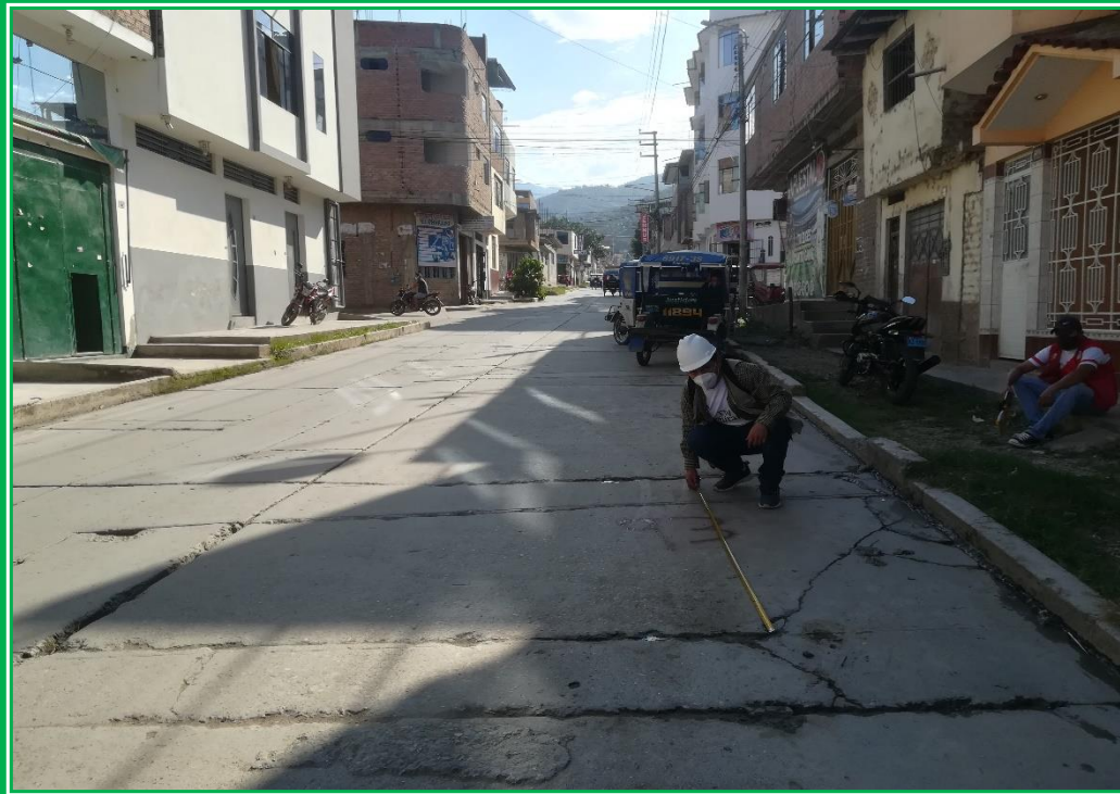
Foto 17. Paño 93, en la U-05, en la Cuadra N° 10, con fallas de 01 Losa Dividida (23) de severidad Alto; 02 Parche Grande (29 de severidad alto).
