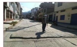
PAÑO 86 - ROMPEMUELLE EN MAL ESTADO Y PARQUES GRANDES EN SEVERIDAD ALTA
