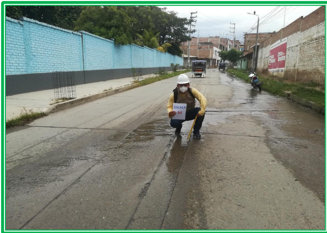
Foto 11. Paño 73, de 3.50 x 5.00 m en la U-04, con fallas de 01 Escala (25) de severidad Medio y Pulimiento de superficie (31) de severidad Alto.
