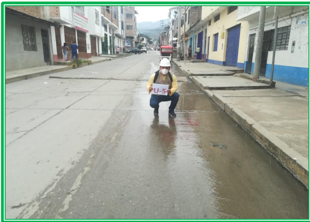
Foto 13. Paño 81, en la U-05, en Progresiva 0+198.0 Km, en la Cuadra N° 10, con fallas de 01 Losa Dividida severidad Alto y 02 Grietas lineales severidad Medio.
