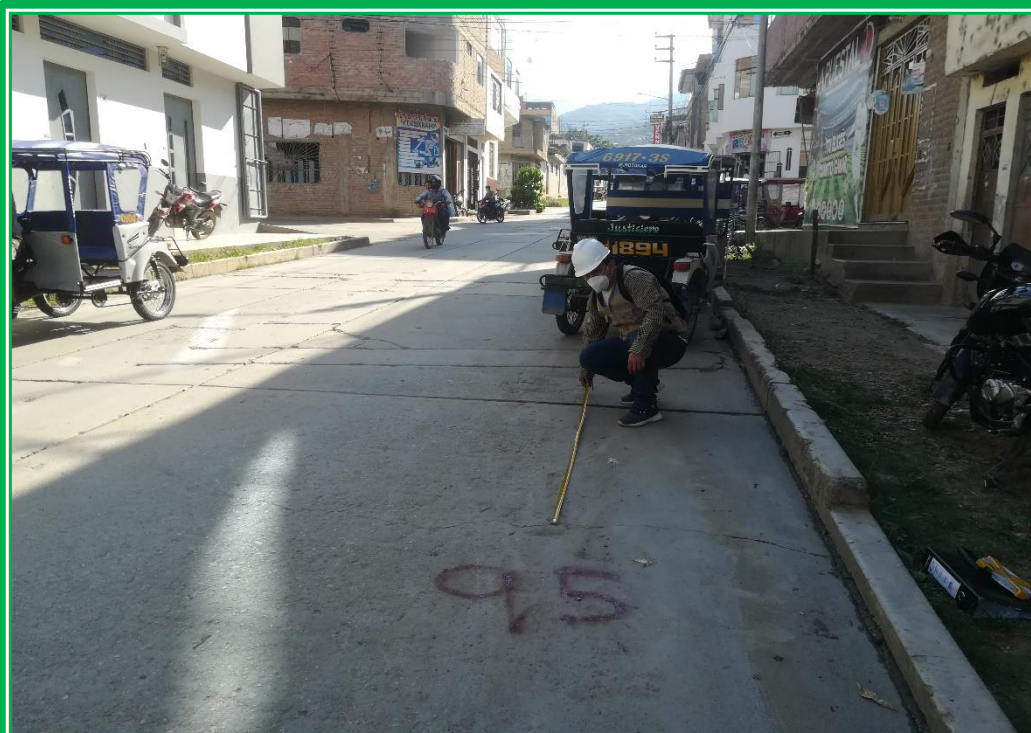
Foto 18. Paño 95, en la U-05, en la Cuadra N° 10, con fallas de 01 Grieta Lineal (28) de severidad Medio.
