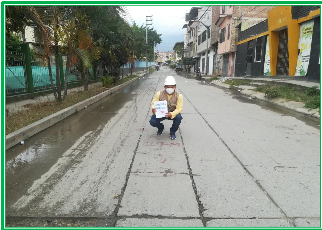
Foto 03. Paño 6, de 3.50 x 5.00 m en la U-01 , con fallas de 02 Parche Grande (29) de severidad Leve y Medio; 01 Pulimiento de superficie (31) de severidad Medio .
