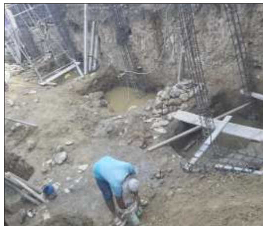
Figura 4. Filtraciones de agua observados en obra N° 04
