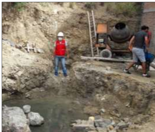
Figura 3. Filtraciones de agua observados en obra N° 02
