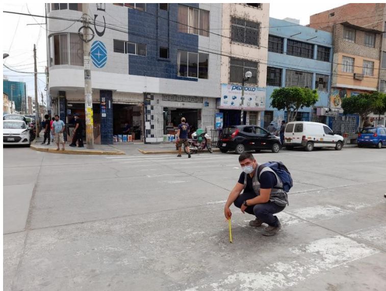
Falla por desprendimiento Av. Pedro Ruiz c-8
