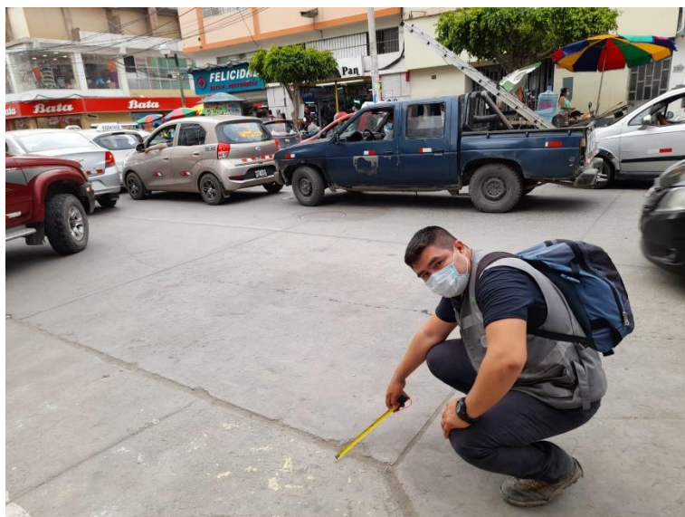
Fisura en juntas Av. Pedro Ruiz c-7
