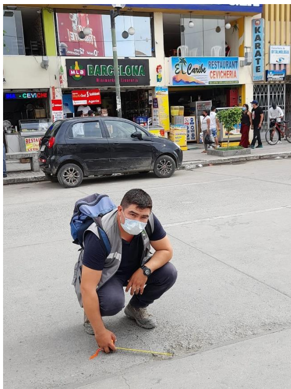
Falla por desprendimiento y fisura en juntas Av. Pedro Ruiz c-8
