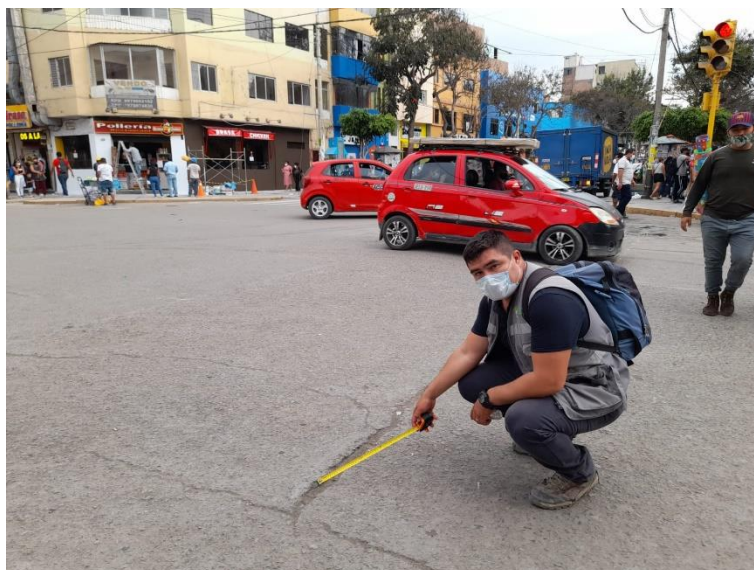
Falla por desprendimiento y fisura en juntas Av. Pedro Ruiz c-6
