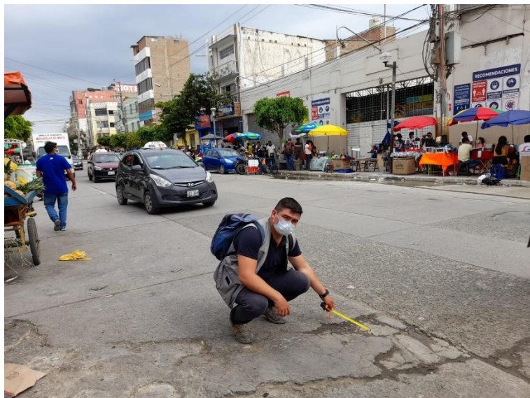
Falla por desprendimiento, fisura en junta y hundimiento Av. Pedro Ruiz c-7
